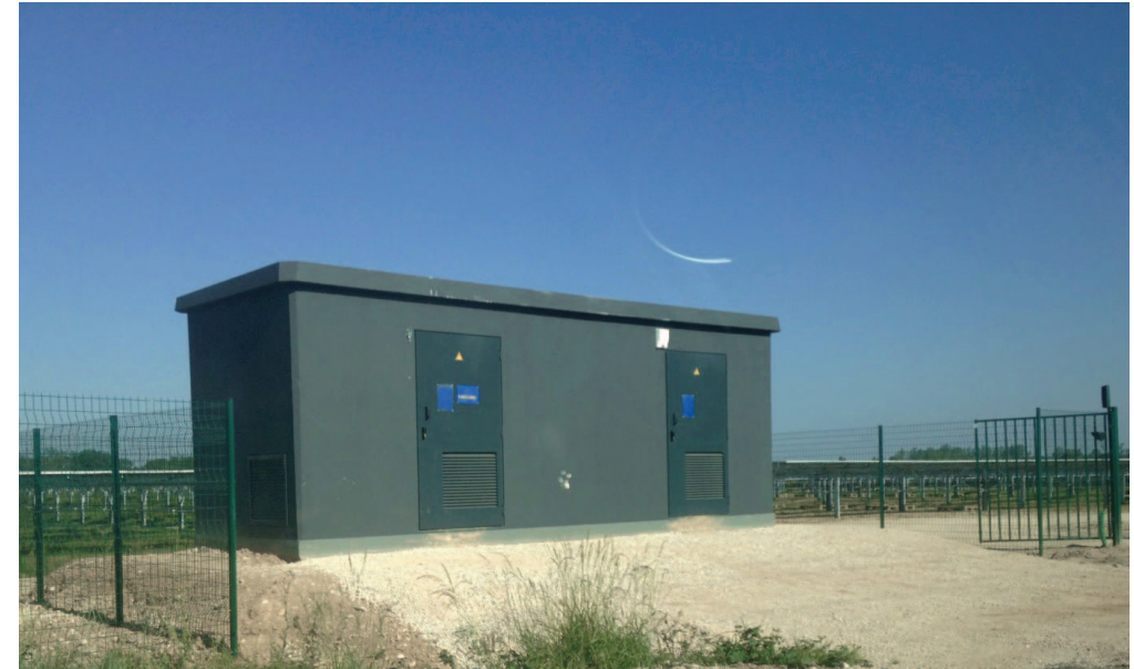
Vue du poste de livraison - Béton peint vert RAL 6011- Photographie d'illustration générique
